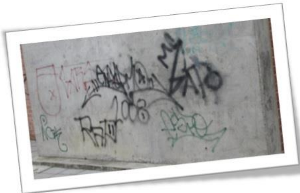
Figura N°42. Graffiti vandálico patio del colegio N°4
