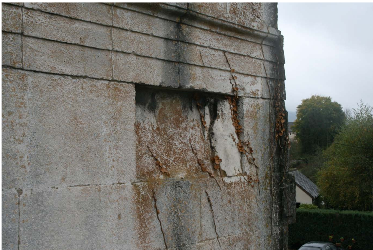
Détail de la façade : le bloc à la face de parement éclatée (PAX-23).
