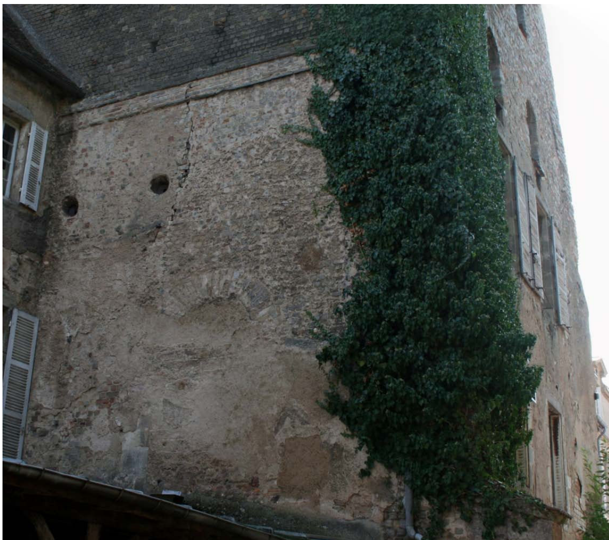
Même vue, détail. En bas, une ouverture cintrée, ultérieurement bouchée (très probable accès entre le chemin de ronde et la galerie supérieure de la porte).
