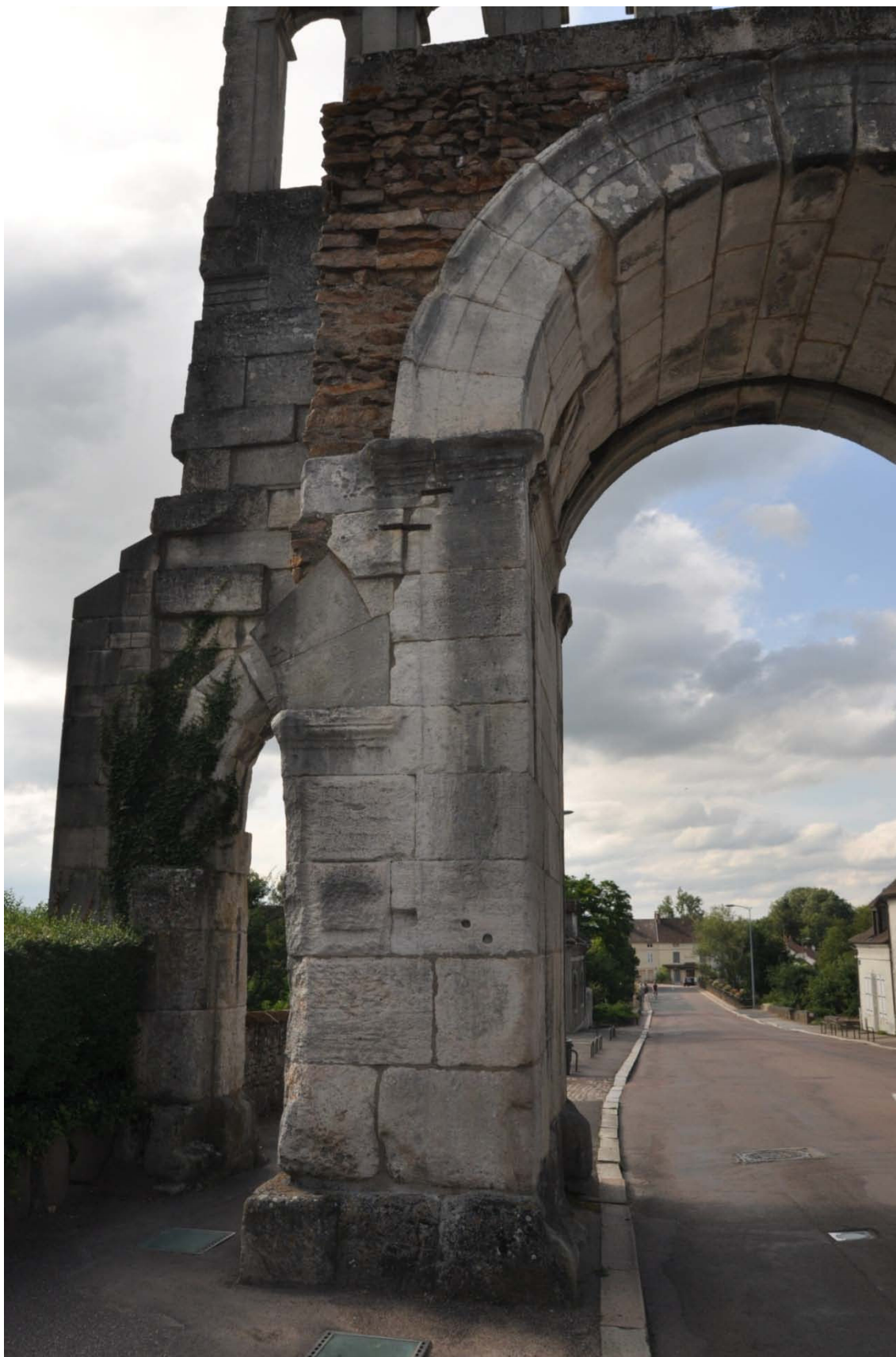
Face arrière, piédroit latéral oriental : on observe sur le piédroit, sur le sommier et le claveau suivant une zone non ravalée correspondant à l'aménagement d'un mur perpendiculaire en petit appareil.
