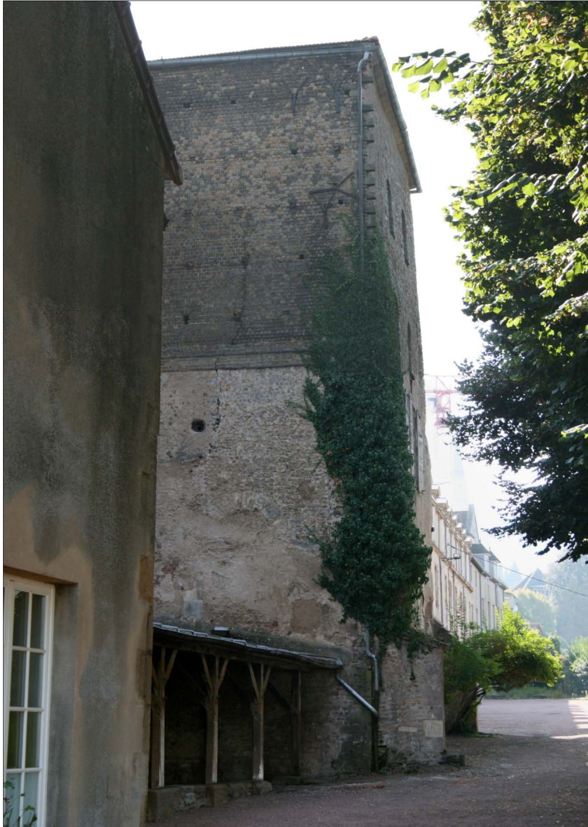
Paroi extérieure nord de la tour. Le trou circulaire qui apparaît sous le pseudo-entablement pourrait correspondre à un ancien système de tirants métalliques destinés à assurer l'intégrité architecturale de la structure.
