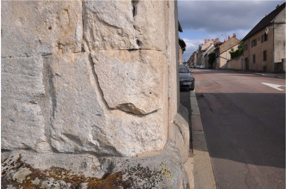
Assise inférieure de PAX-10 (façade côté campagne) : les deux trous visibles correspondent aux fixations ayant permis de recoller le fragment détaché du parement (intervention XXI ème siècle).
